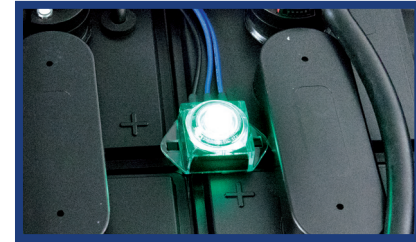
Le niveau d'électrolyte est OK
